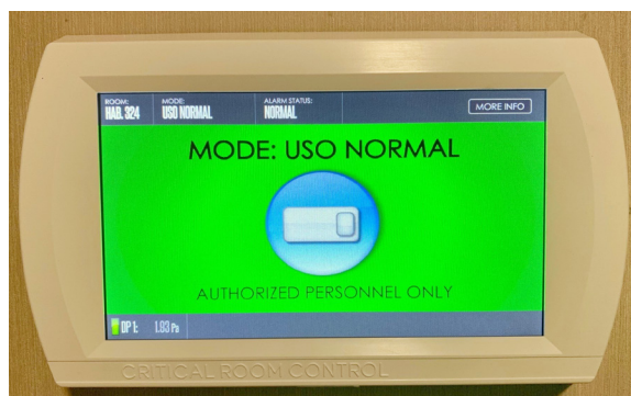
Detalle de dispositivo de control
