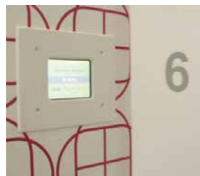
Detalle de dispositivo de control
