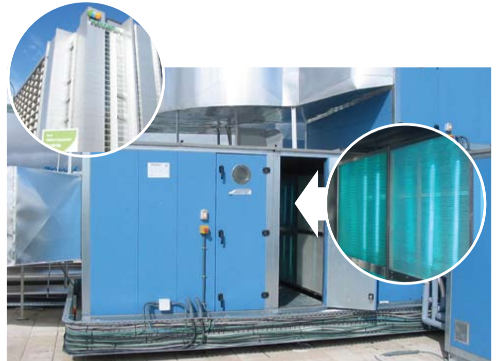
Detalle de la instalación: sistema de purificación de aire por fotocátalisis adaptado al climatizador de aporte de aire primario.
